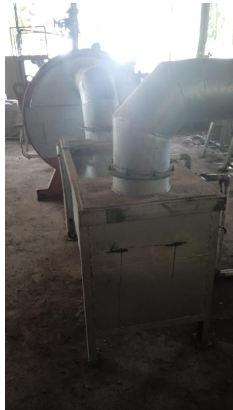
Boiler tampak depan
