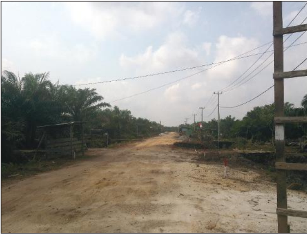
Gambar 5.33 Kondisi salah satu jalan yang terdapat di Desa Badar Jaya
