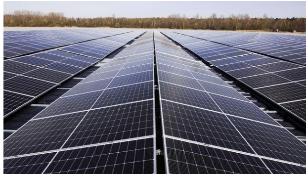
Gambar 1. Pembangkit Listrik Tenaga Surya
