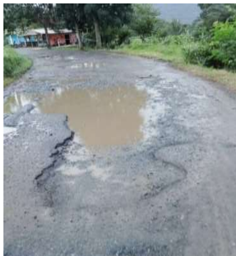
Gambar 1.1 Bukti jalan rusak
